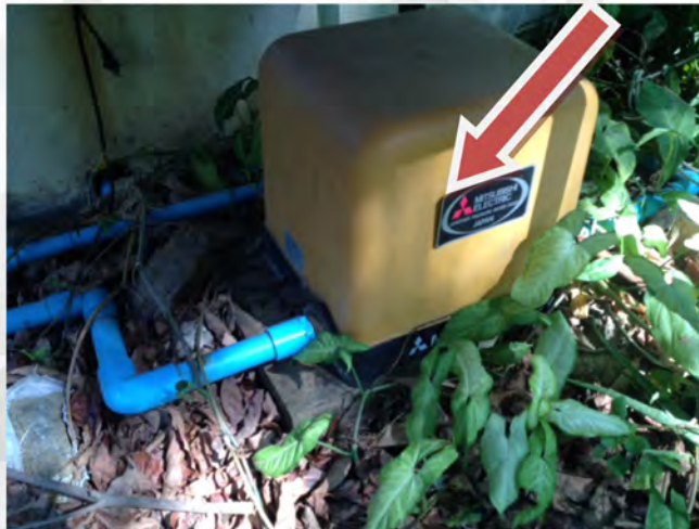
P7 บั้มสูบน้ำเรือนเพาะชำ ติดตั้งอยู่บริเวณด้านหลังของเรือนเพาะชำ
